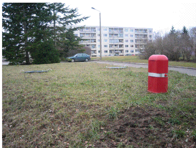
Joonis 4.6 Saku aleviku Tiigi tn tuletõrjemahuti välisvaade
