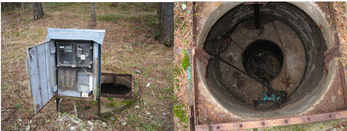
Joonis 4.18 RP-Männiku Küla pumpla välisvaade ja sisevaade
