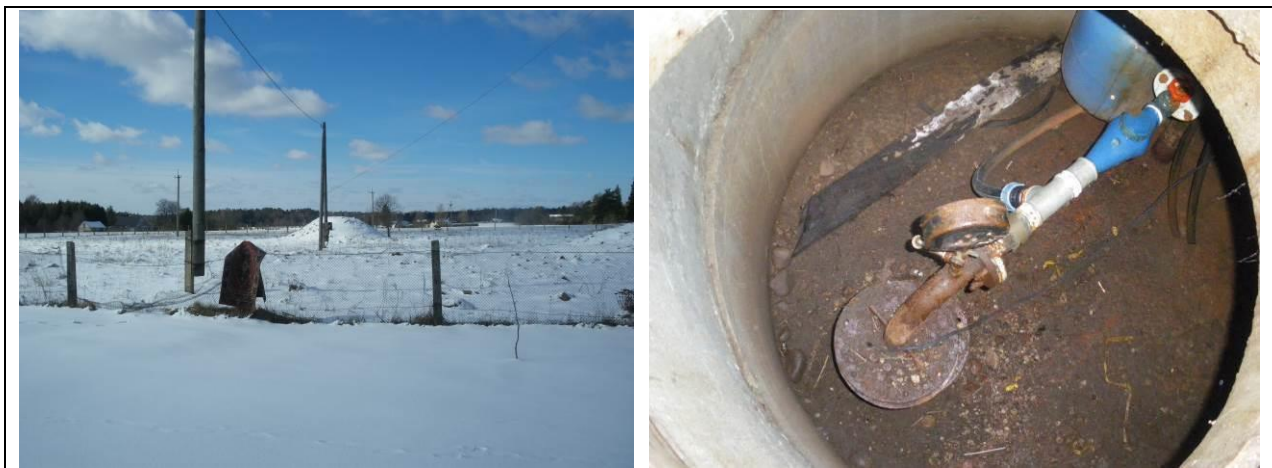
Joonis 4.31 Tagadi keskuse puurkaevpumpla (katastri nr 1650) välis- ja sisevaade
