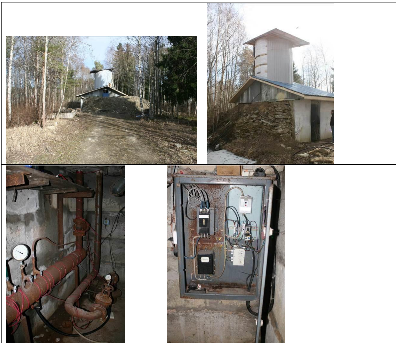
Joonis 4.45 AÜ Trelli-II puurkaevpumpla (katastri nr 19779) välis- ja sisevaade
