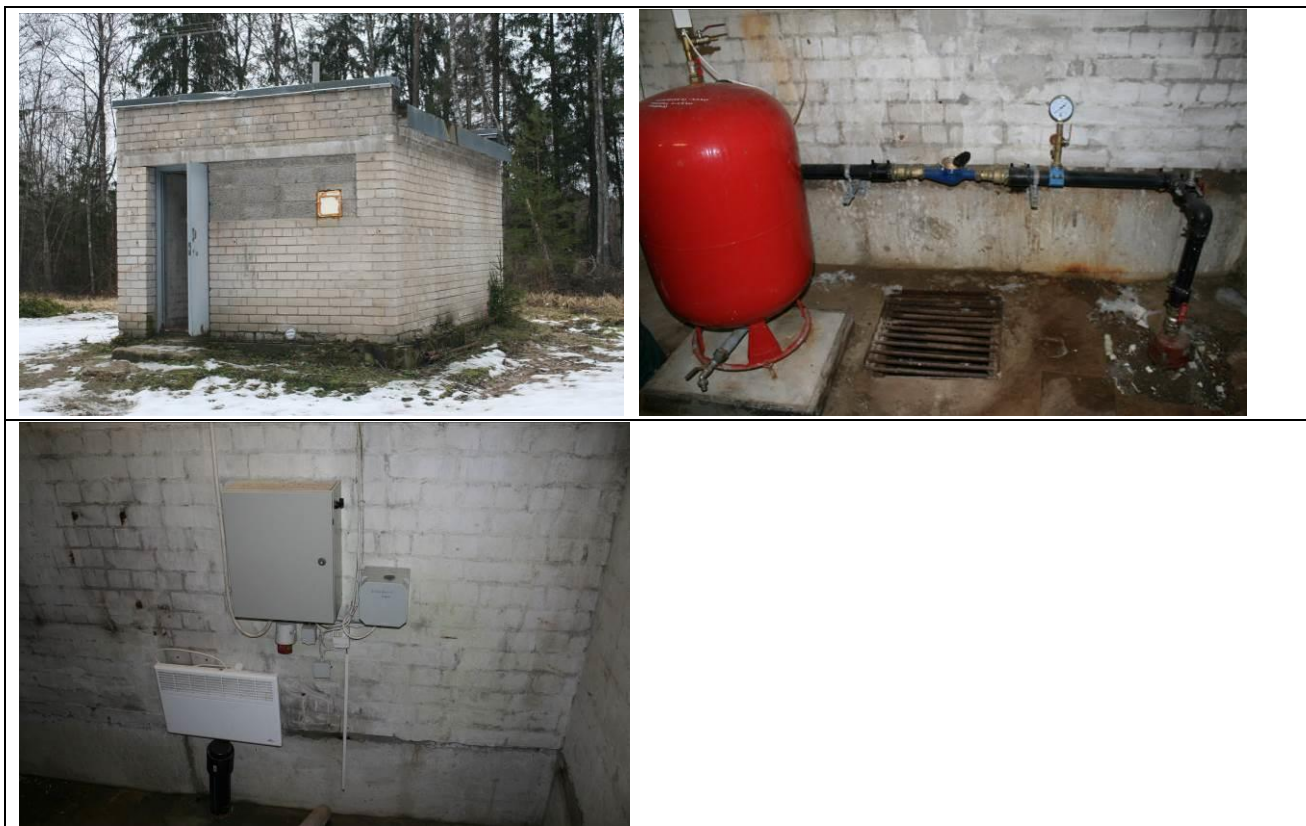
Joonis 4.35 Kiisa (Roobuka) puurkaevpumpla (katastri nr 1578) välis- ja sisevaade
