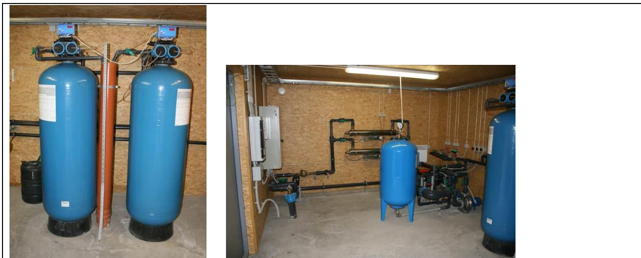
Joonis 4.34 Metsanurga puurkaevpumpla (katastri nr 21816) välis- ja sisevaade
